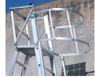
BARANDA CON ARO GUARDA HOMBRE EN PLATAFORMA
